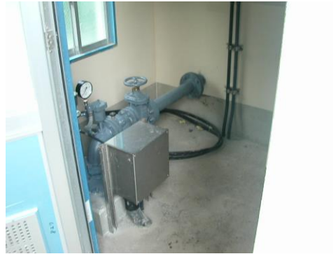
写真－6 柵子下水源取水ポンプ
